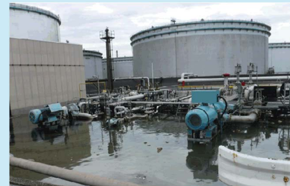
（製油所で発生した冠水被害）
